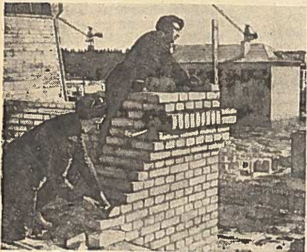
Kauno HES statytojų gyvenvietėje išaugo naujos Statytojų, Mokyklos gatvės ir Taikos skersgatvis. Jau atiduota eksploatuoti 16 gyvenamųjų namų. Bendras jų plotas — daugiau kaip 5 tūkstančiai kvadratinų metrų. Šimtai mūrinių, tinkuotojų, dažytojų lenktyniauja Didžiojo Spalio 40-ųjų metinių garbei. Statant 400 vietų mokyklą sėkmingai dirba mūrinių brigada, kuriai vadovauja Jonas Grinius.
